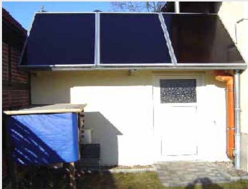
Kollektorfeld als Überdachung mit Luftleitung (rechts)
